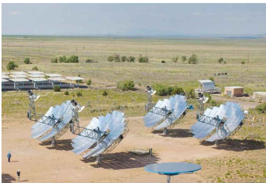
Figura 2.10 - Foto de usina heliotérmica com prato parabólico.
